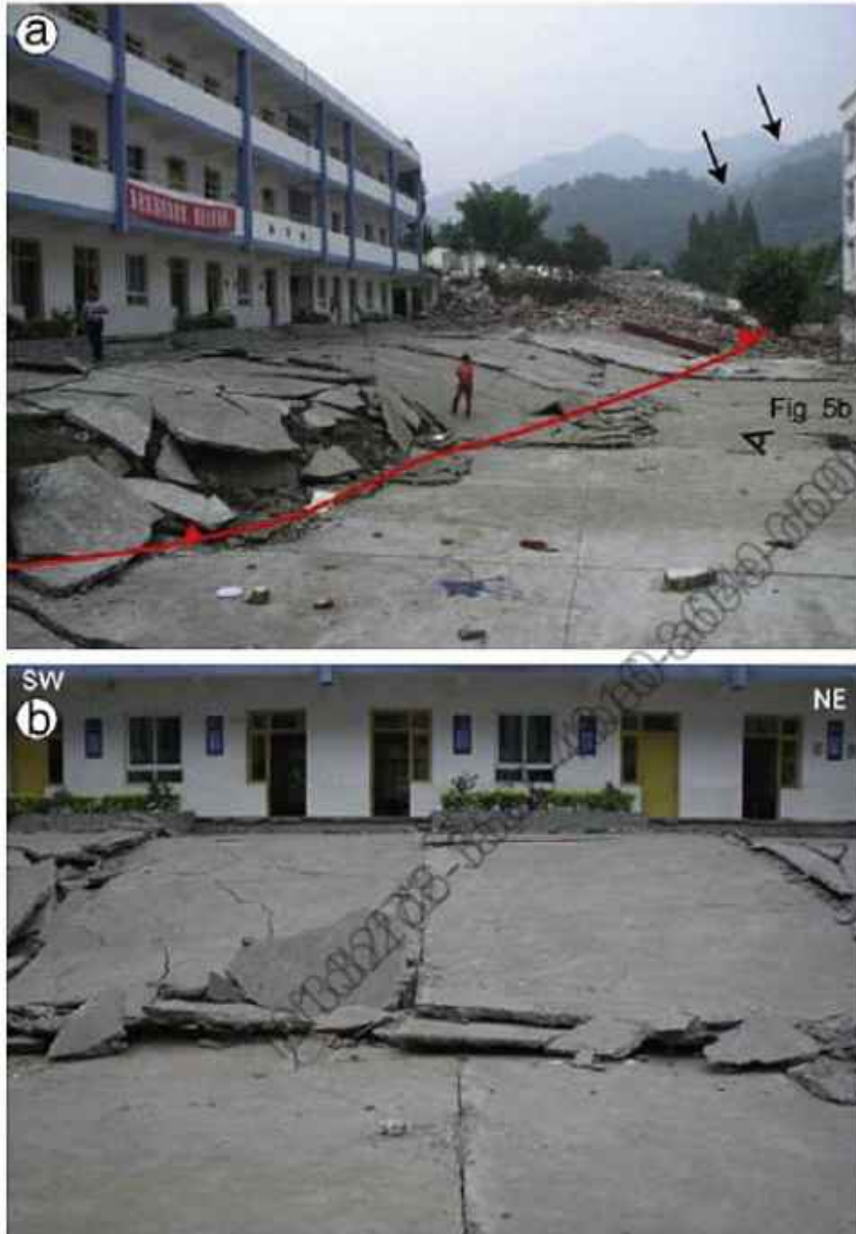
شکل ۷. زون گسیختگی سطحی روی گسل پنگوان در شهر بایلو چین در زلزله وتچوان ۲۰۰۸ [۳۰]
