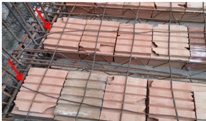
شکل ۱۹. تمهید لازم جهت جلوگیری از ورود بتن به داخل بلوک های مجوف در شکل فوق صورت نگرفته است.
