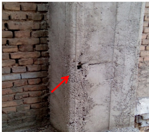
شکل ۱۵. عدم تراکم کافی بتن و دانه بندی نامناسب سنگدانه در عکس دیده می شود.
