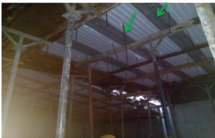
شکل ۲۶. اجرای صحیح آویز برای اتصال سقف کاذب قبل از بتن ریزی سقف و استفاده از تیرچه بتنی در عکس دیده می شود.
