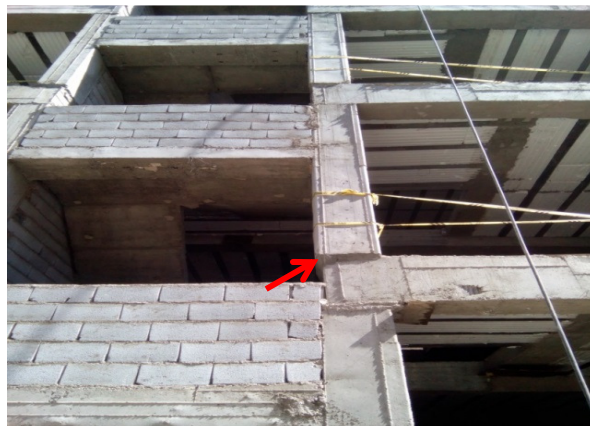
شکل ۱۰. قالب بندی نامناسب در محل اتصال تیر به ستون
