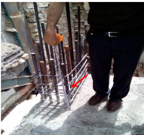
شکل ۲. کوتاه بودن طول وصله پوششی میلگردهای ستون
