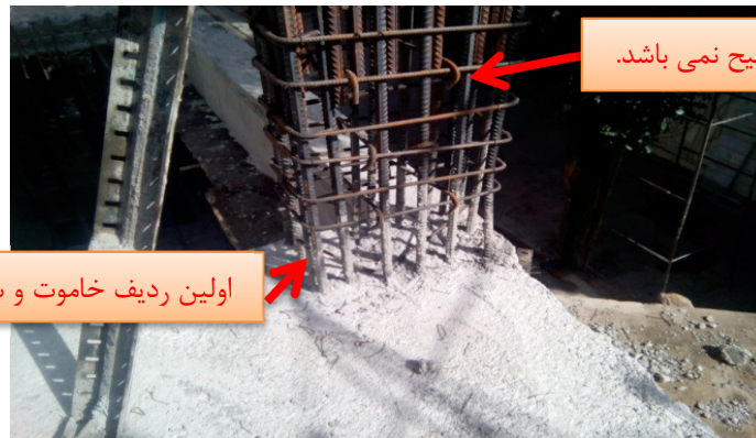
شکل ۷. وضعیت نامناسب خاموت گذاری و عدم مهار آرماتور طولی ستون توسط سنجاقی ها
