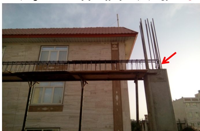
شکل ۵. عدم اجرای خاموت های محل اتصال تیر به ستون (هسته اتصال ستون)
