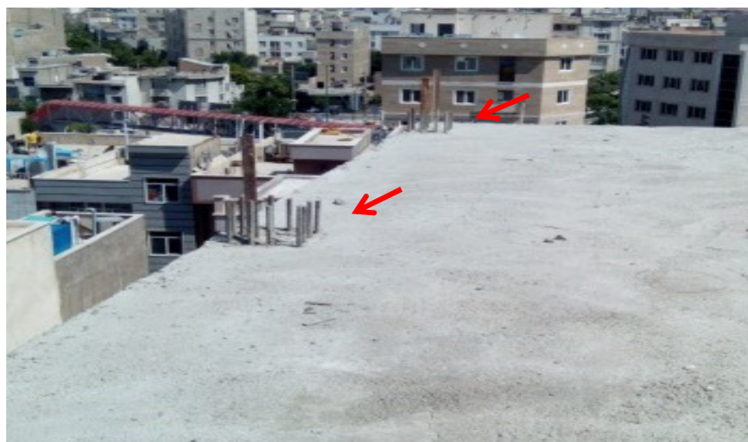
شکل ۱. عدم مهار مناسب آرماتور طولی ستون در سقف آخر (این عکس نشان می دهد که خم ۹۰ درجه آرماتور طولی انتهای ستون اجرا نشده است.)
