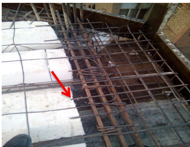
شکل ۲۱. عدم رعایت طول مهاری لازم آرماتور ممان منفی دال بتنی در سقف دیده می شود.
