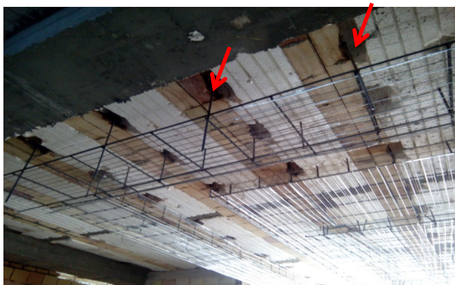
شکل ۲۵. استفاده از تیرچه فندوله ای و شکستن کاور تیرچه برای اتصال آویز سقف کاذب مجاز نمی باشد.
