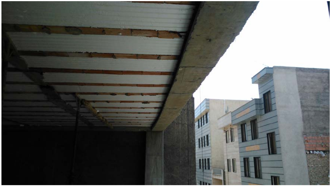
انحنای جانبی تیر و پیچش قالب
