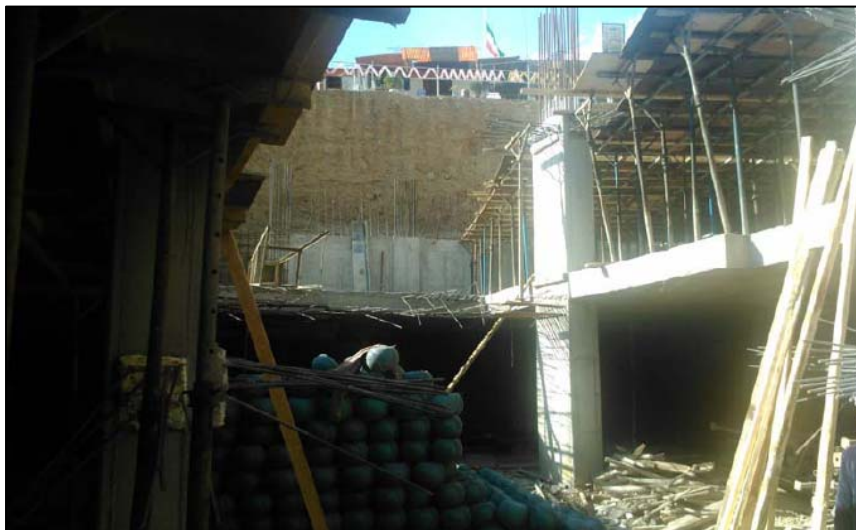
اجرای نامناسب سیستم سقف کوبیاکس
