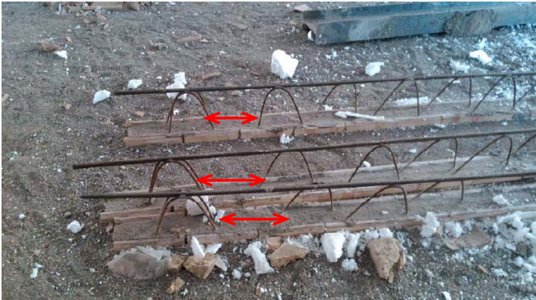
ساخت غیر استاندارد تیرچه‌های سقفی
