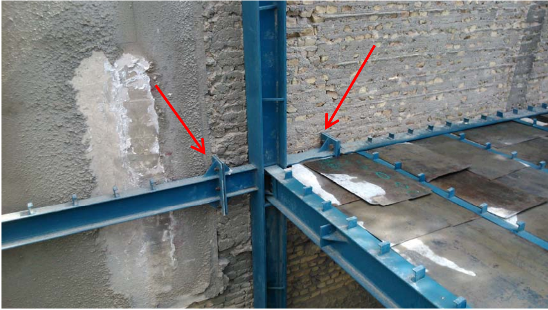
عدم امکان بستن پیچ ها در مجاورت ساختمان همسایه
