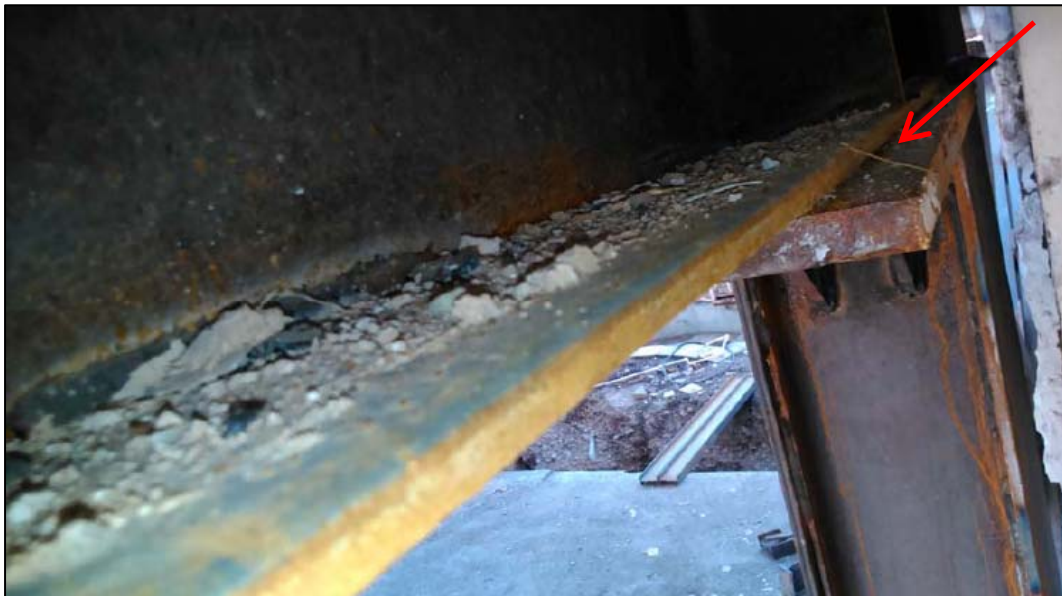
عدم امکان اجرای جوش اتصال تیر، به ورق زیرسری در مجاورت ساختمان همسایه
