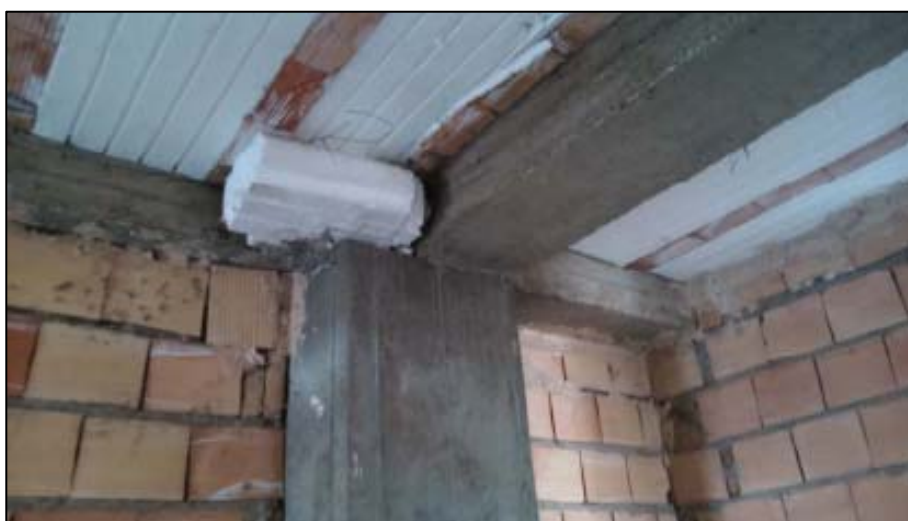
قالب بندی غیر اصولی منجر به کاهش سطح مقطع بتن در ناحیه اتصال شده است
